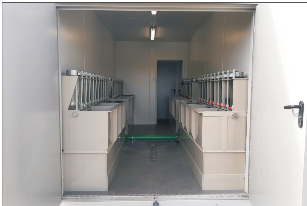
Fot. 4. Widok gotowego kontenera hodowlanego wyposażonego w dwa zestawy aparatów inkubacyjnych typu Weissa i dwa zestawy aparatów inkubacyjnych typu McDonald, Zakład Rybactwa Jeziorowego w Giżycku (fot. D. Ulikowski).
